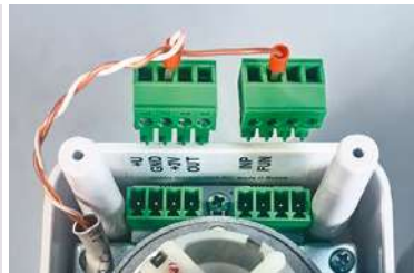
Фото 23. Подключение проводного выключателя
