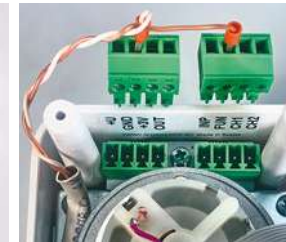
Фото 18. Подключение проводного выключателя к электроприводу
