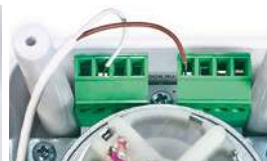
Фото 15. Подключение датчика к электроприводу
